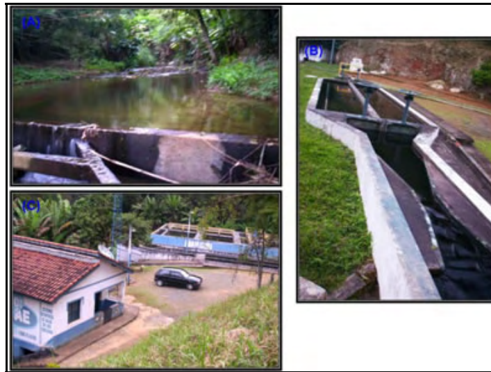
Figura 12. Aspecto da captação de água na bacia do Batedor.
